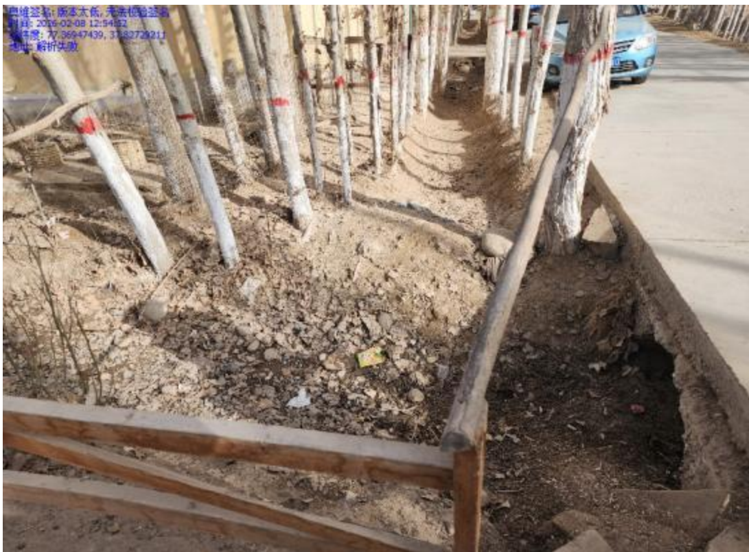
图 5.1-3 4 村 2 组斗渠 3 现状 现状不足：现状为土渠，分水口简陋，部分入户桥桥面较低。
