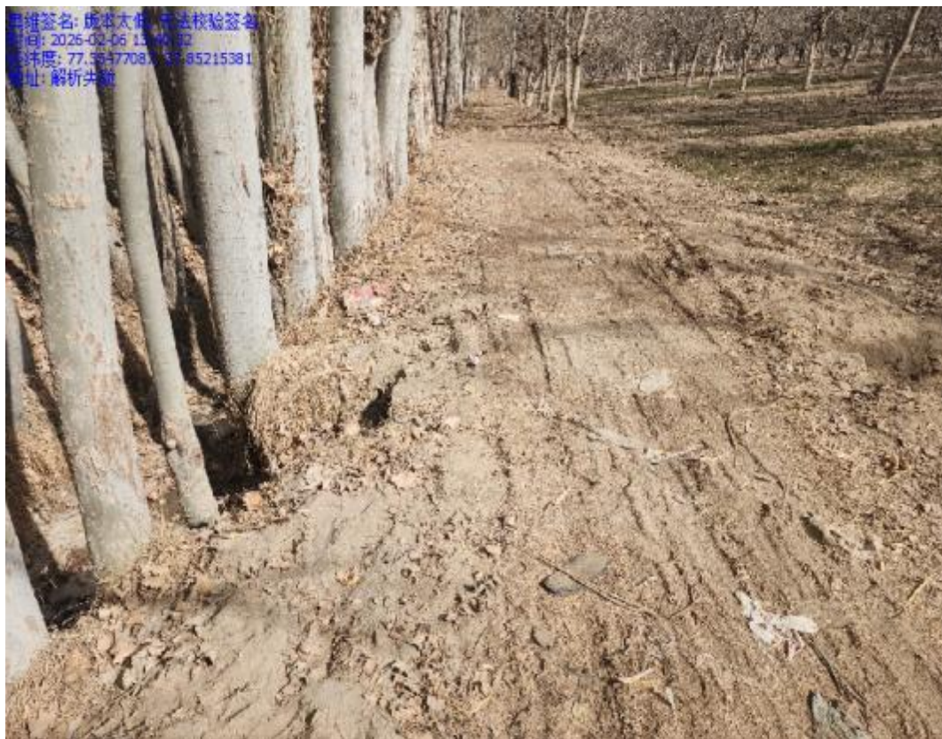
图 5.1-13 10 村 1 组斗渠 13 现状 现状不足： 现状为土渠，伐树较多，分水口简陋，涵桥缺失。
