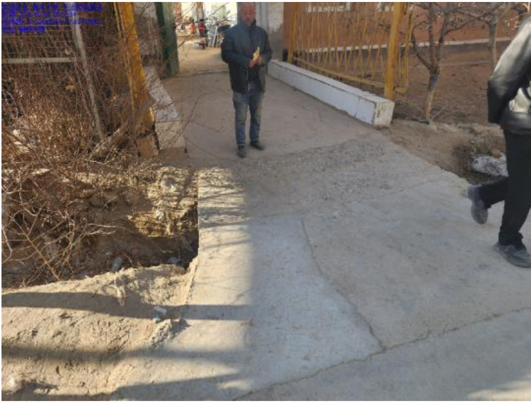
图 5.1-2 2 村 3、4 组斗渠 2 现状 现状不足：现状为土渠，杂物淤积严重，部分入户桥桥面较低。
